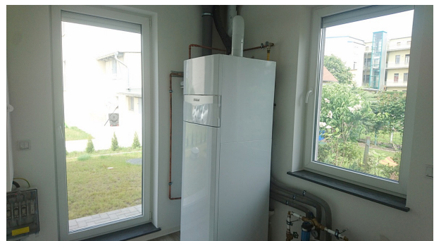
Hauswirtschaftsraum mit Hausanschlüssen und Tageslicht
